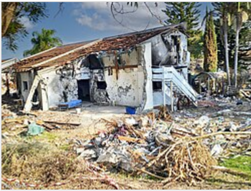
Jeden z budynków w kibucu Be'eri, zniszczony podczas ataku Hamasu 7 października 2023 roku (zdjęcie wykonano 4 grudnia 2023 roku)
